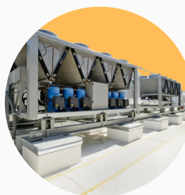
SISTEM HVAC KHUSUS
