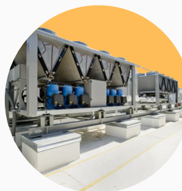
SISTEM HVAC KHUSUS
