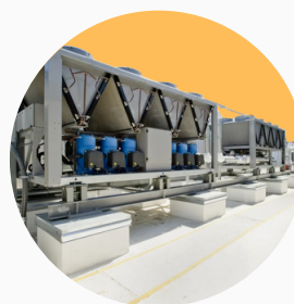
SISTEM HVAC KHUSUS
