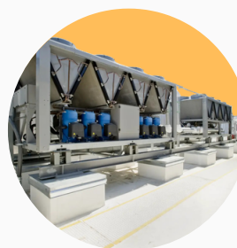
SISTEM HVAC KHUSUS
