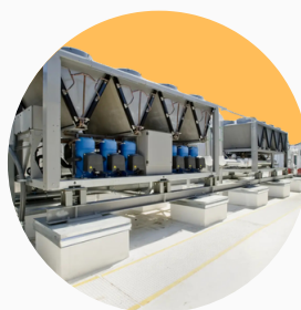
SISTEM HVAC KHUSUS
