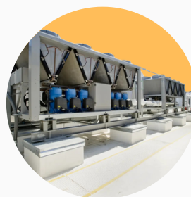
SISTEM HVAC KHUSUS
