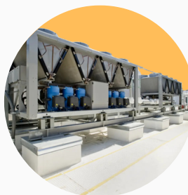
SISTEM HVAC KHUSUS
