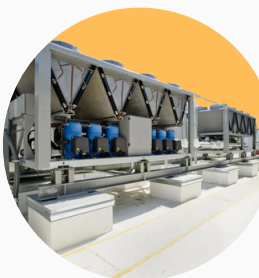
SISTEM HVAC KHUSUS
