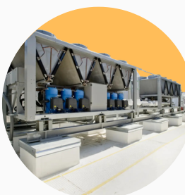
SISTEM HVAC KHUSUS
