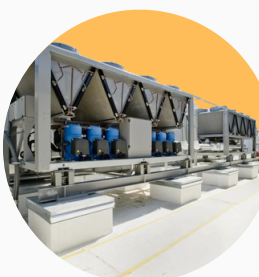
SISTEM HVAC KHUSUS
