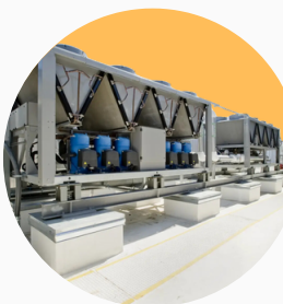
SISTEM HVAC KHUSUS
