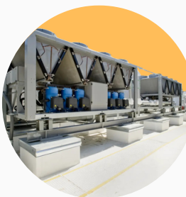
SISTEM HVAC KHUSUS
