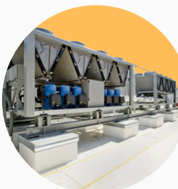
SISTEM HVAC KHUSUS
