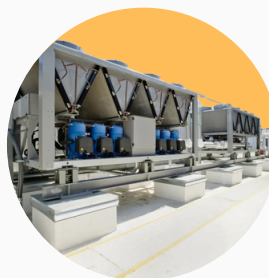
SISTEM HVAC KHUSUS
